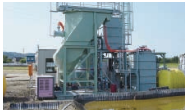
排水処理設備
