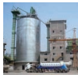
フライアッシュセメント製造設備
