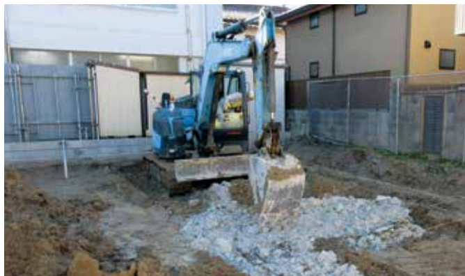
バックホウによる敷均し状況(使用固化材:防塵型固化材)
