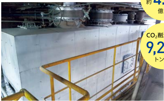
含水原料混合装置(外観)
