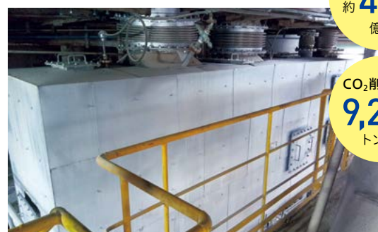
含水原料混合装置(外観)
