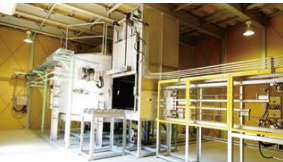
リチウムイオン電池焙焼設備
