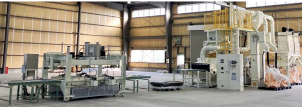
廃太陽光パネル処理設備
