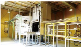
リチウムイオン電池焙焼設備
