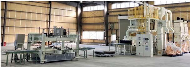
廃太陽光パネル処理設備
