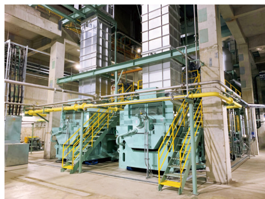
埼玉工場 ガスエンジン発電設備
