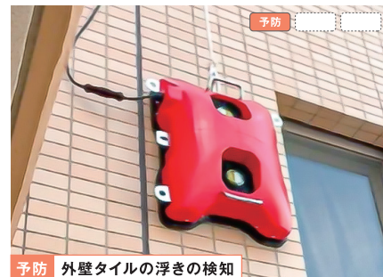
予防 外壁タイルの浮きの検知
