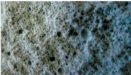
写真-1 レコキープLAの硬化体割裂断面
