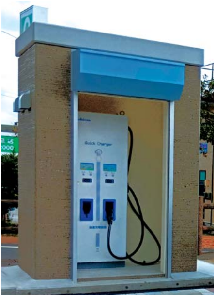
写真-4 EV急速充電器と倉庫
