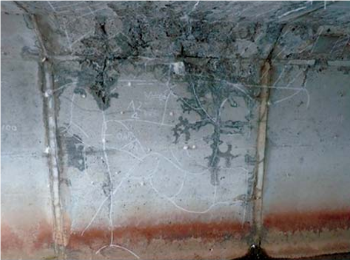
写真-4 側壁損傷状況
