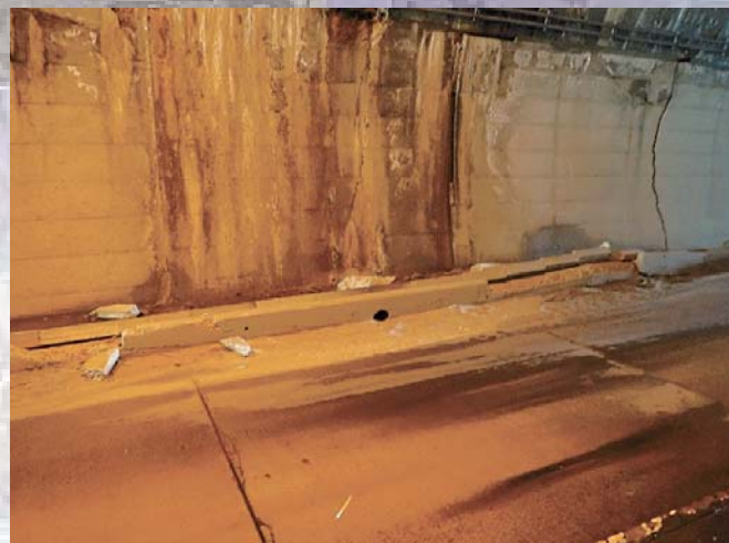
写真-1 輪島市のトンネル覆工の崩落(2025年5月)
