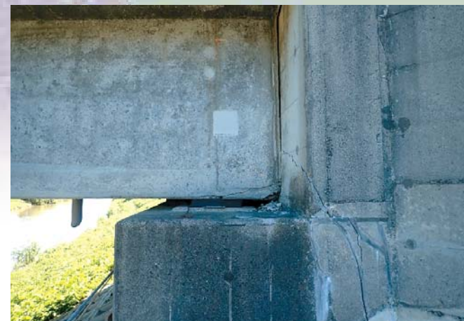
写真-4 輪島市の道路橋の端部損傷(2024年8月)
