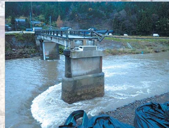
写真-5 輪島市の道路橋の流失(2024年12月)
