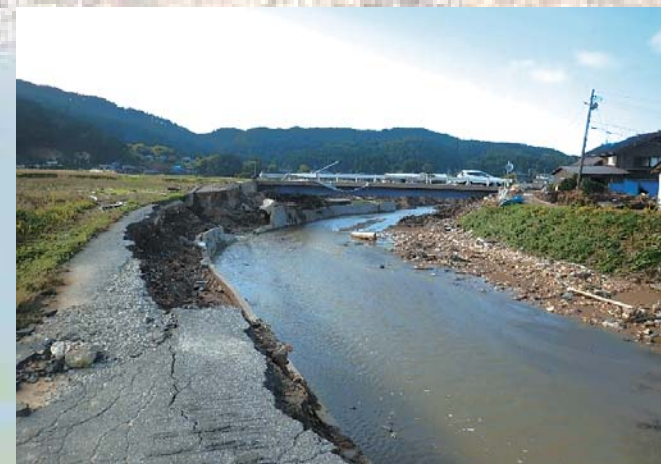
写真-6 輪島市の護岸の流失(2024年10月)
