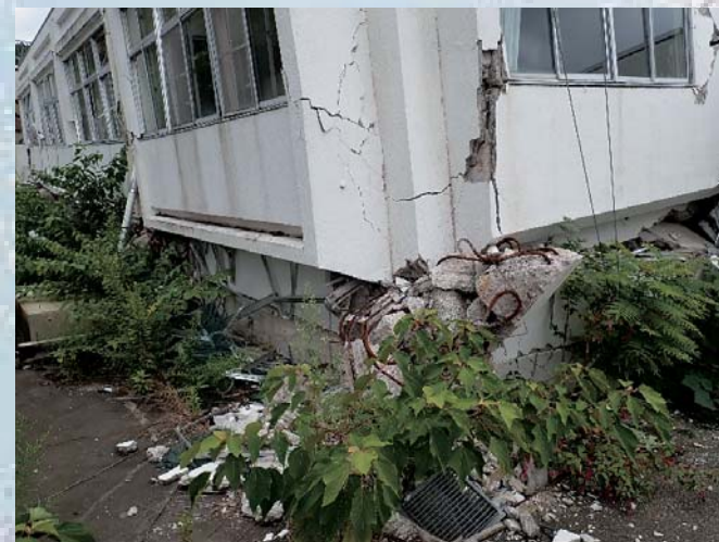
写真-3 輪島市のRC建物の倒壊(2024年8月)
