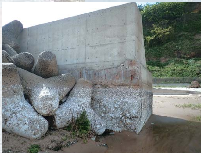
写真-2 輪島市の漁港の堤防の隆起(2024年1月)
