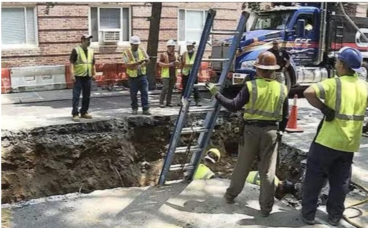
ニューヨークでの道路崩落
