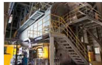
新設された粉碎ミル
