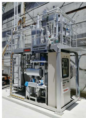
CO 2 分離回収テストプラント
