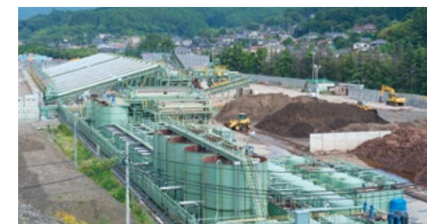
除塩設備(大船渡工場)(2012年当時)
