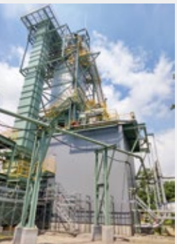
上磯工場 廃プラスチック受入処理設備
