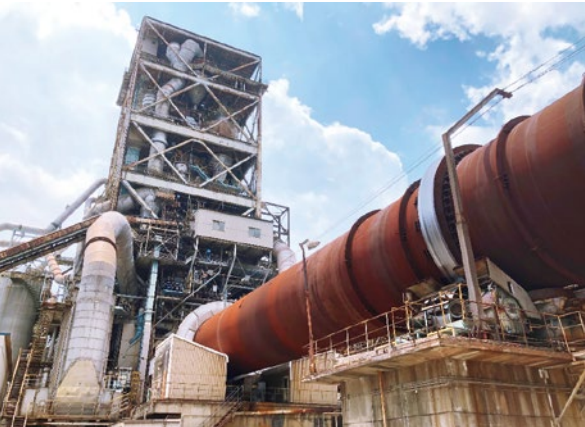
藤原工場5号キルン(高効率クリンカクーラーを導入)
