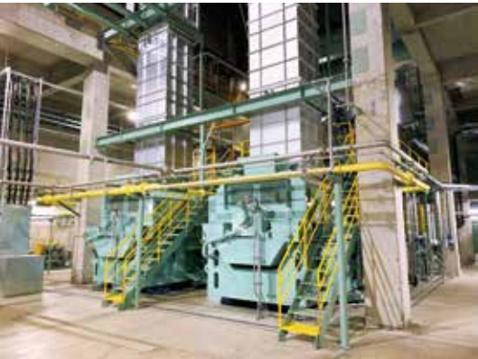
埼玉工場 ガスエンジン発電設備
