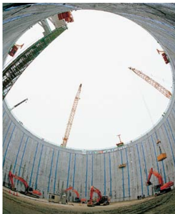
仙台LNG基地新港工場
