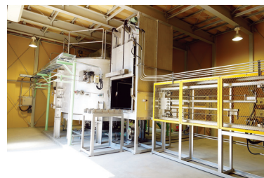
リチウムイオン電池焙焼リサイクル設備
