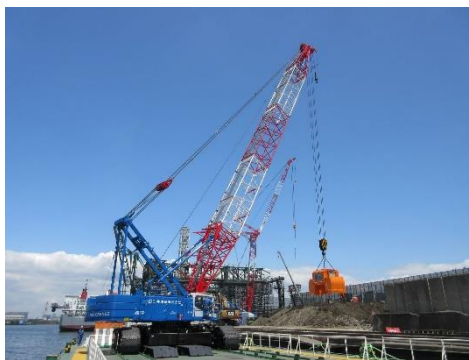
フローティングクレーン
