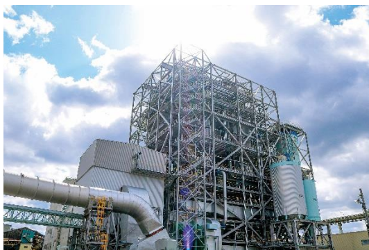
バイオマス発電所
