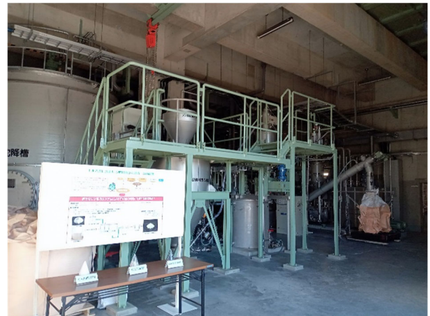
【りん回収・肥料化施設】
