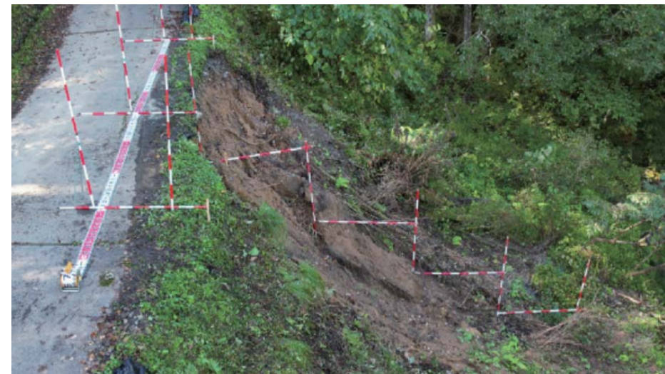
写真-1 村道法面の被災状況
