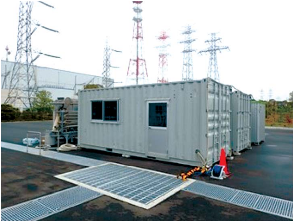
写真-2 リン回収実証設備外観
