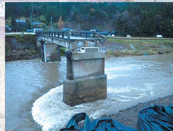
写真-5 輪島市の道路橋の流失(2024年12月)
