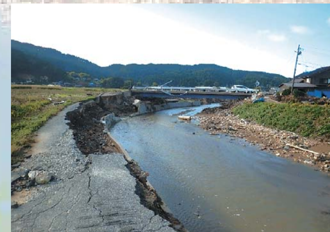
写真-6 輪島市の護岸の流失(2024年10月)
