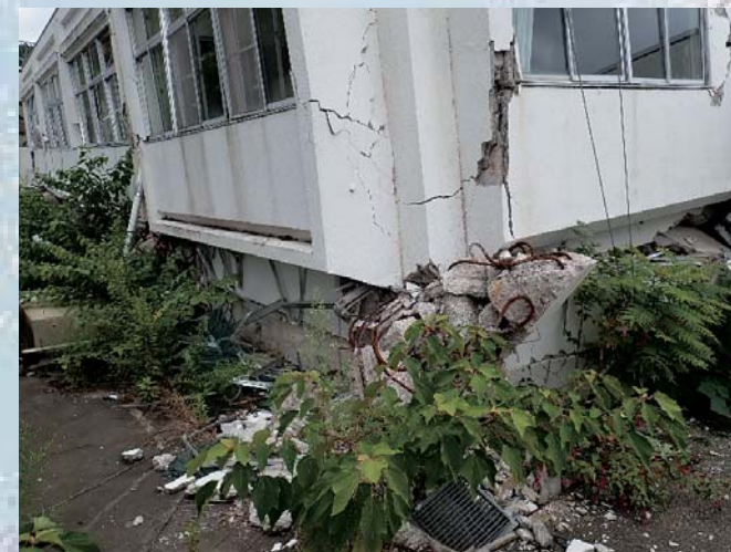
写真-3 輪島市のRC建物の倒壊(2024年8月)
