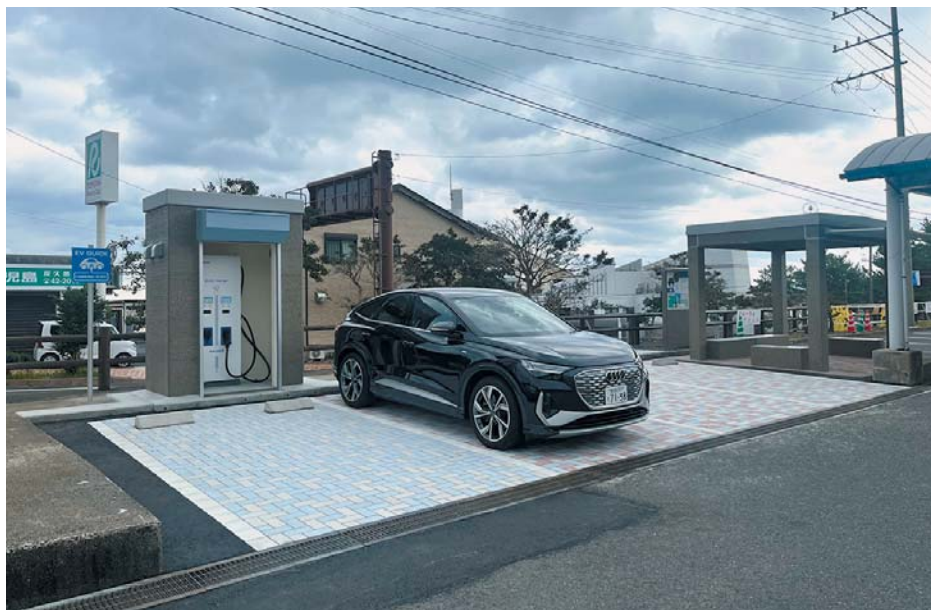
写真-1 EV急速充電ステーション全景
