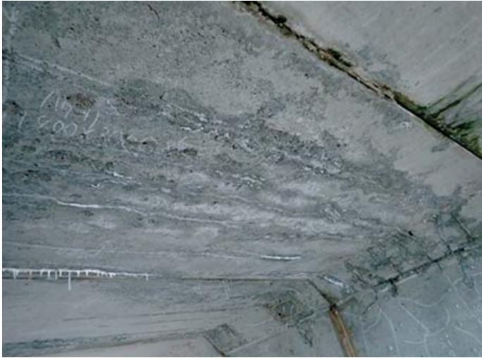
写真-3 頂版損傷状況
