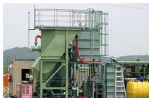
可搬型排水処理装置
