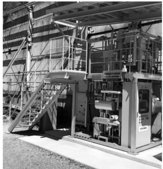
Fig. 3 CO 2 capture test plant (CO 2 分離回収プラント)
