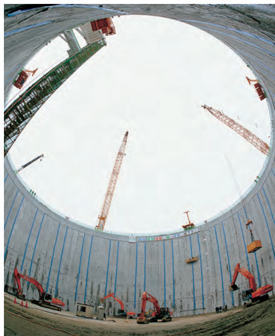
仙台LNG基地新港工場
