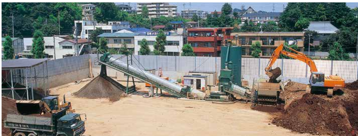
建設発生土改良プラント
